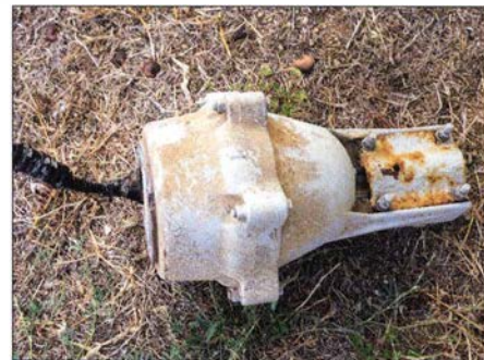
Bild 6: Das Klima Arubas setzt dem Material hart zu; Rost und Salzablagerungen bereits nach kurzer Zeit.
