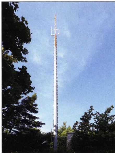
Der Mast von DB0BPY auf der Ottensteiner Hochebene in JO41PW Foto: DL5QD
