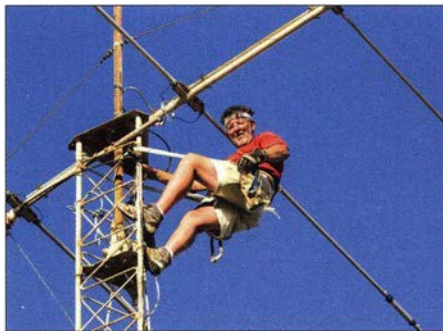
Bild 5: John, W2GD, demontiert eine der defekten TH7-Yagi-Antennen.
